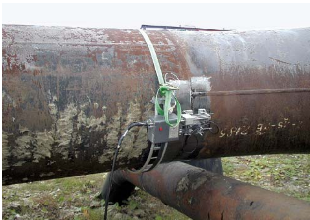
Рис. 4. Контроль системой «Авгур 4.2» трубопровода Ду 1200 на ГКС
