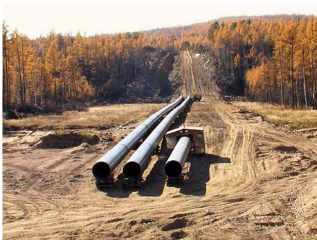
Рис. 8. Плети нефтепровода на производственной площадке
